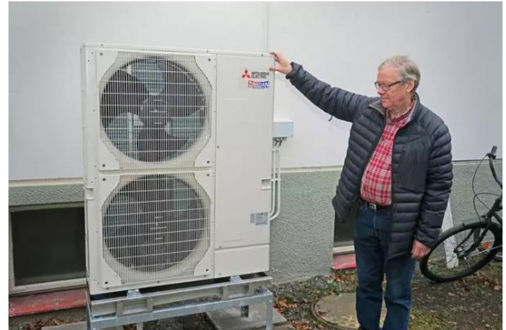
Sakari Telilä esittelee ilma-vesilämpöpumppua, joka valittiin Kaukolan kylätalon uudeksi lämmitysjärjestelmäksi.
